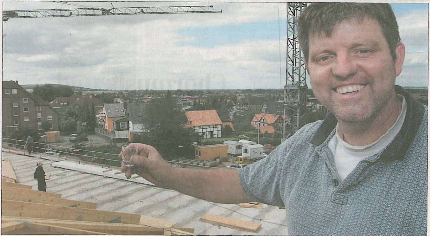
„Geweihet sei dieses Haus zur Stund' – so Glas zersplittere am Grund“. Zimmerer-Meister Michael Pieper aus Damme hat den Richtspruch einwandfrei vorgetragen. Im Rohbau besichtigen Investor Dirk Wilhelm Rahlfs (Bild unten, rechts), Architekt Gerrit Niemeier (hinten), Bürgermeisterin Gudrun Olk, Stadtdirektor Bernd Reese und Günter Rahlfs senior die Deckenkonstruktion. Voss (2)
